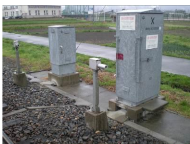
踏切障害物検知装置
