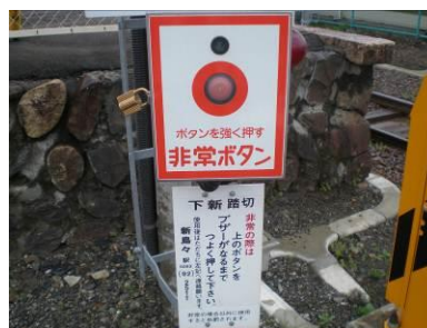
踏切支障報知装置
