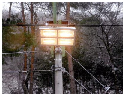
パンタグラフ融雪装置
