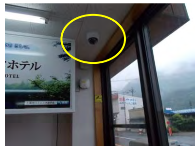
防犯カメラ（駅待合室）
