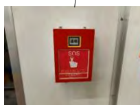
非常通報装置
